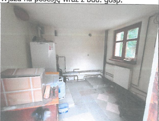
Dom mieszkalny - kotłownia
