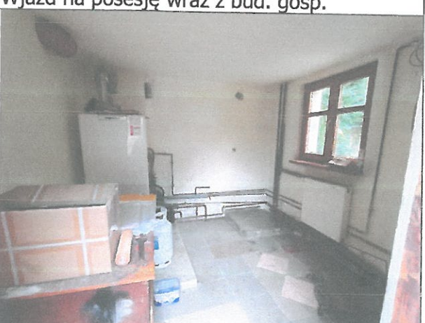
Dom mieszkalny - kotłownia
